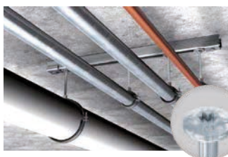
Carriles de montaje
